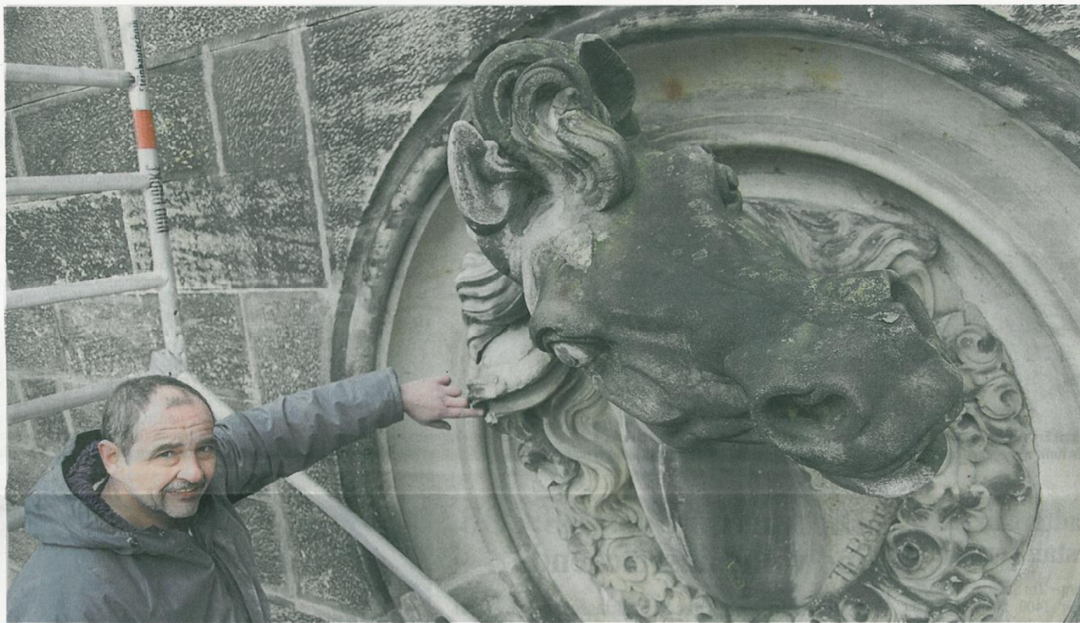
In luftiger Höhe inspizierte gestern Michael Sommer den bröckelnden Pferdekopf über dem Eingang der Reithalle. Die nicht ganz einfache Sanierung kann aber erst beginnen, wenn die Temperaturen wieder dauerhaft über dem Gefrierpunkt sind. Bis dahin wird mit einem Netz verhindert, dass Teile des Sandsteins herunterfallen. Fotos: Oliver Schmidt
